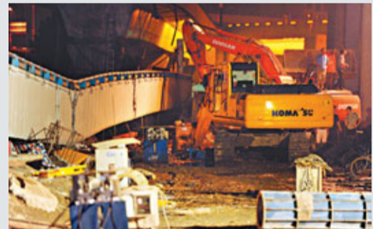
■高架墜落 24日,安徽合肥一高架長約90米的匝道在抬升工程中墜落,現場27名工人中,26人安全撤離,1人遇難。
