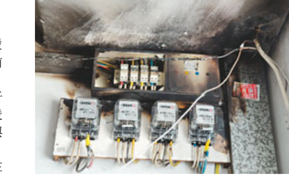
唐樓梯間電錶被縱火燒毀。
