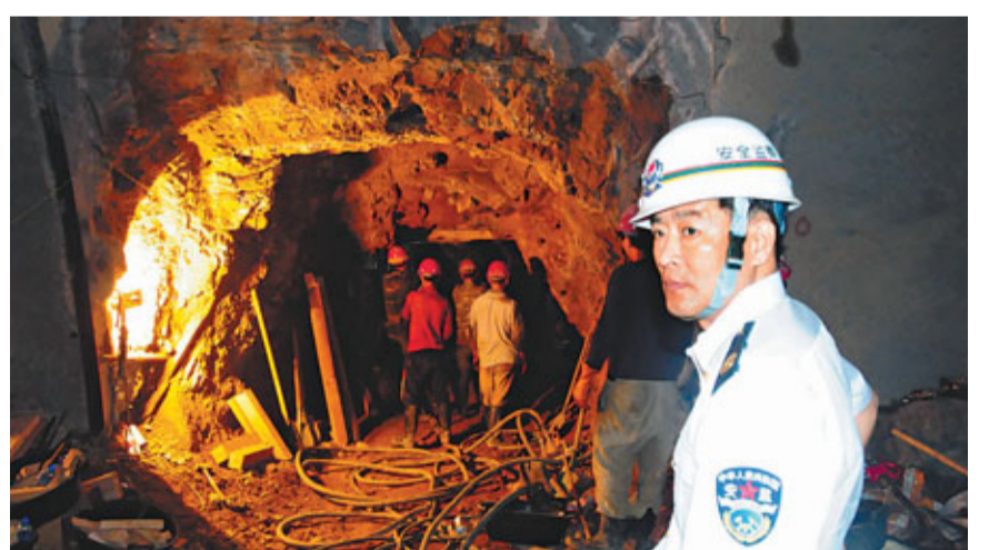
■ 19日5時30分左右，在大連隧道坍塌事故現場，救援人員連續人工作業挖掘救援通道。
