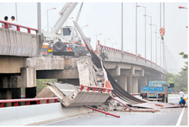
15日凌晨，杭州第三錢塘江大橋南端橋面出現部分塌落，一輛重型半掛車從橋面墜落。新華社
