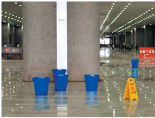
■原本裝潢亮麗的南京高鐵站出現大面積漏水，滴水集中處的下方有5、6個大桶在接水。網上圖片
