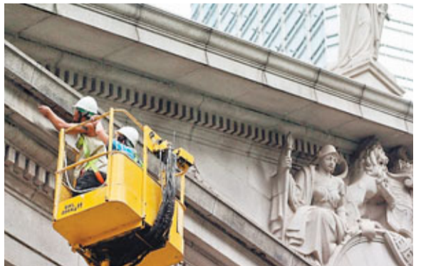
立法會大樓外牆石屎突然剝落，當局緊急派員檢查。 香港文匯報記者莫雪芝 攝
