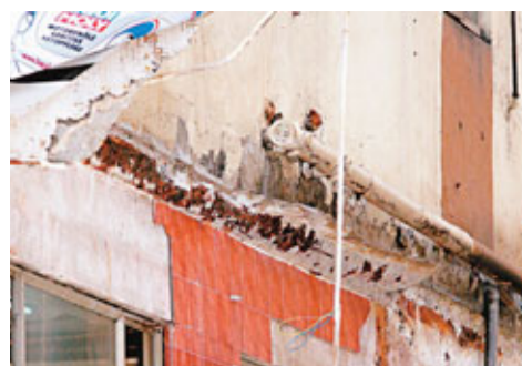
發生倒塌懸臂式簷篷可看出牆身鋼筋生銹。香港文匯報記者 溫瑞麟 攝
