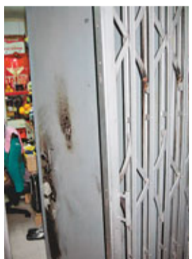
被縱火燒毀大門布簾的單位,木門亦被熏黑。
