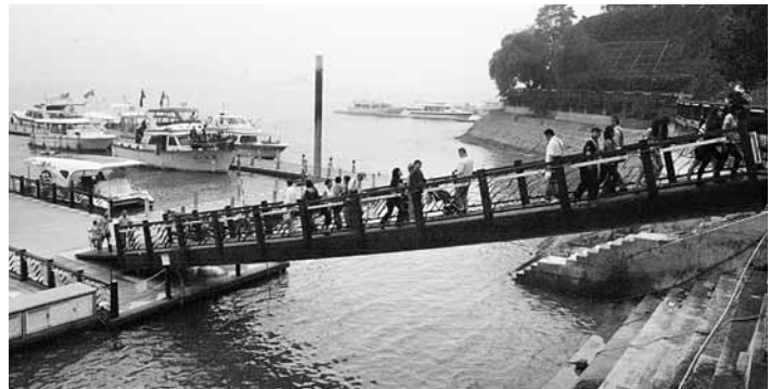
■日月潭碼頭引橋斜度落差仍大，水位再不回升，引橋不能通行，碼頭可能被迫暫停開放。中央社
