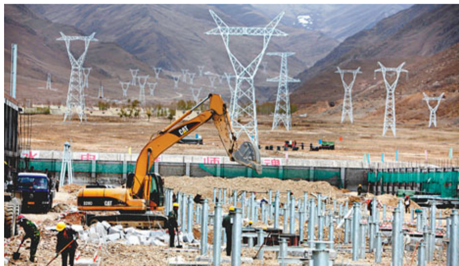
電力天路 青藏交直流聯網工程進入攻堅階段。總投資達162億元的青藏聯網工程被稱為「電力天路」, 建成後將使西藏電網與全國電網實現聯網, 從根本上解決西藏缺電問題。圖為24日, 山東省送變電公司的員工在拉薩換流站工地安裝220千伏交流接觸網。新華社
