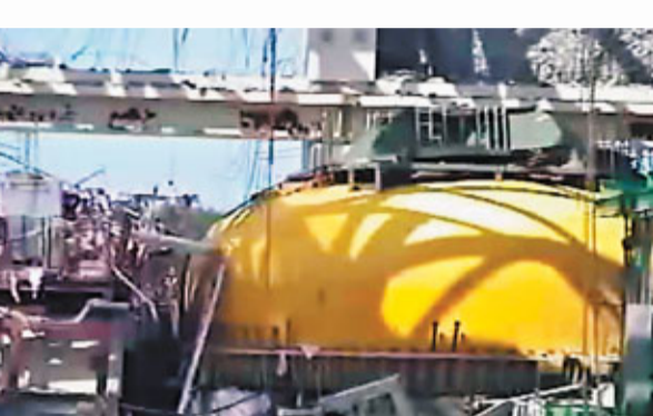
4號機組損毀，露出反應堆操作地區。
