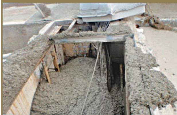
輻射水量太大，導致混凝土無法凝固，堵塞裂縫失敗。 路透社
