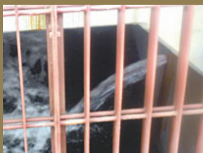
輻射水大量從裂縫湧出豎井。
