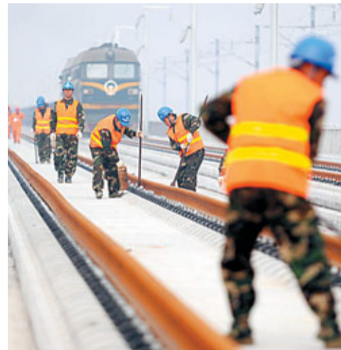
武漢是中部地區鐵路樞紐，目前正在尋求與西安連接高鐵。圖為武漢高速鐵路正在鋪軌。資料圖片
