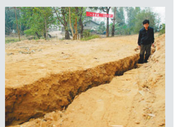
村寨邊的大盈江堤壩震後的裂縫有兩條大腿那麼寬。中新社
