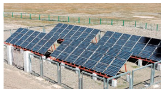
玉珠峰站的太陽能設施。
