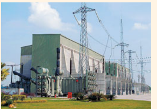
「十一」期間，貴州「西電東送」、「兩直五交」建成，貴州電網電力外送能力達到900萬千瓦以上。圖為±500千伏安順換流站。 張軍焰 攝
