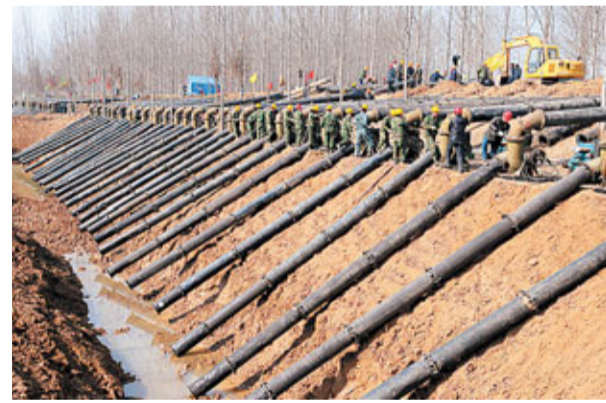
在江蘇省宿遷一抗旱工程現場,工程技術人員在架設、調試抽水機組設備。新華社
