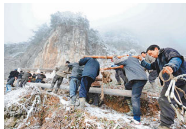
■雲南昭通市大部分地區遭受冰雪災害,地處高寒山區的大關縣許多村寨電桿、電線被冰雪損壞。圖為電力搶修工人在險峻的冰雪山路上運送水泥電桿。新華社
