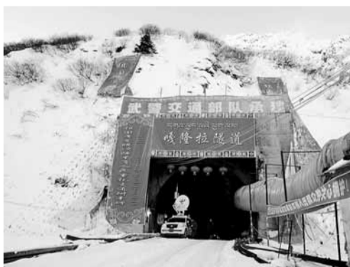
12月15日，全長3310米的墨脫公路控制性工程——嘎隆拉隧道成功貫通。
