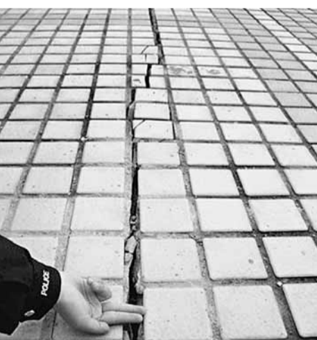
■鳳山縣公路局操場出現的裂縫。
