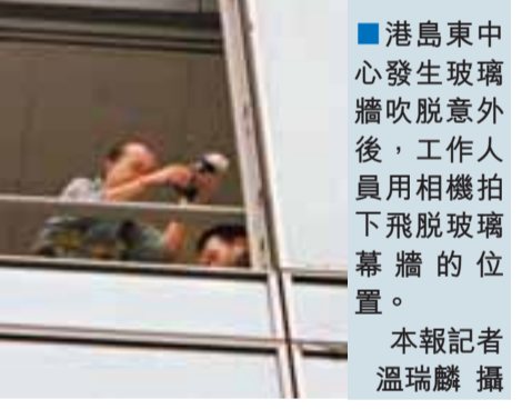
港島東中心發生玻璃牆吹脫意外後，工作人員用相機拍下飛脫玻璃幕牆的位置。本報記者溫瑞麟攝
