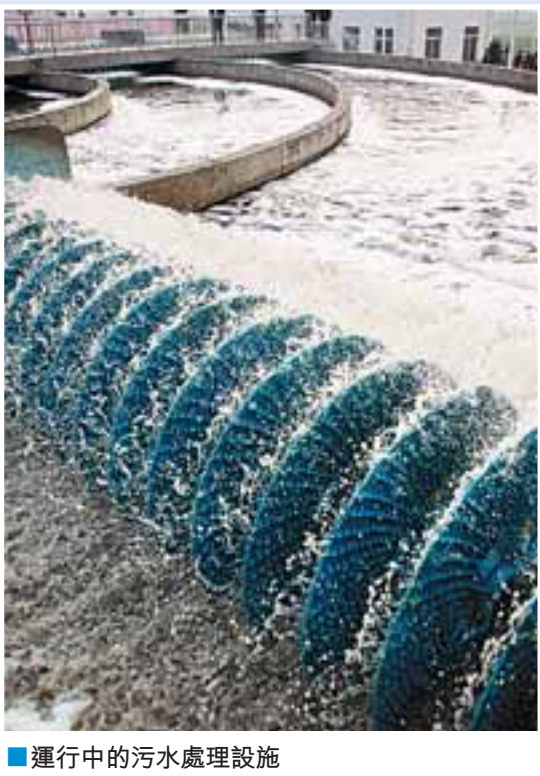
■運行中的污水處理設施
